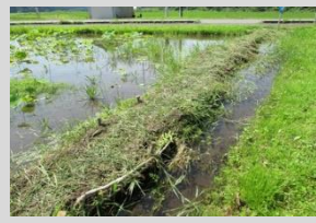
←現在の状況、 側面が崩れて いる。
